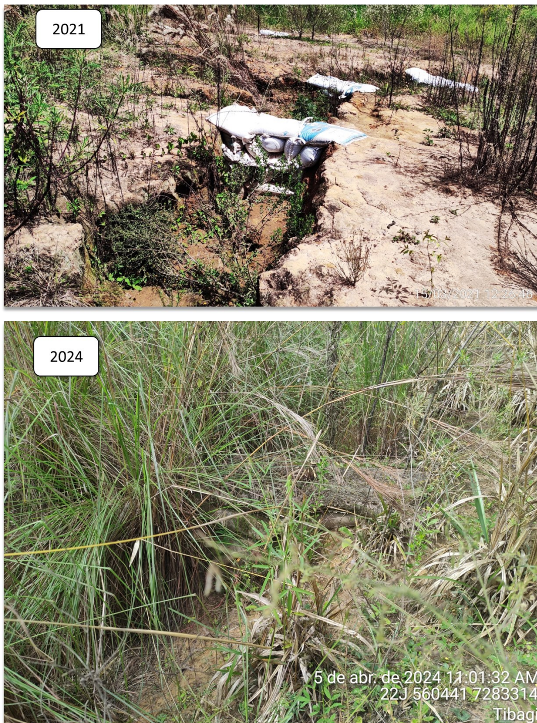
Figura 4: Situação atual do Ponto 3c, demonstrando a estabilidade do rip-rap e a vegetação crescendo dentro da erosão
